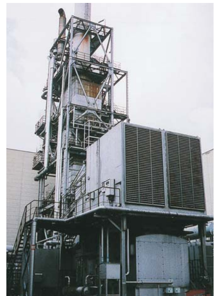
新しく導入された富士宮工場の天然ガス対応設備
