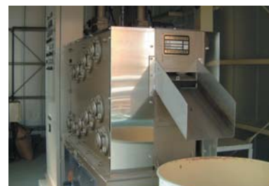
余剰汚泥処理脱水機
