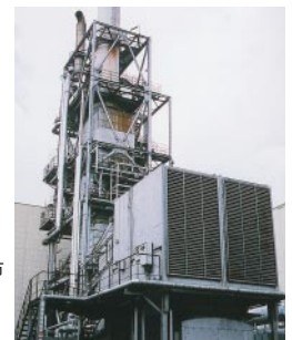
富士宮工場の都市ガス対応設備
